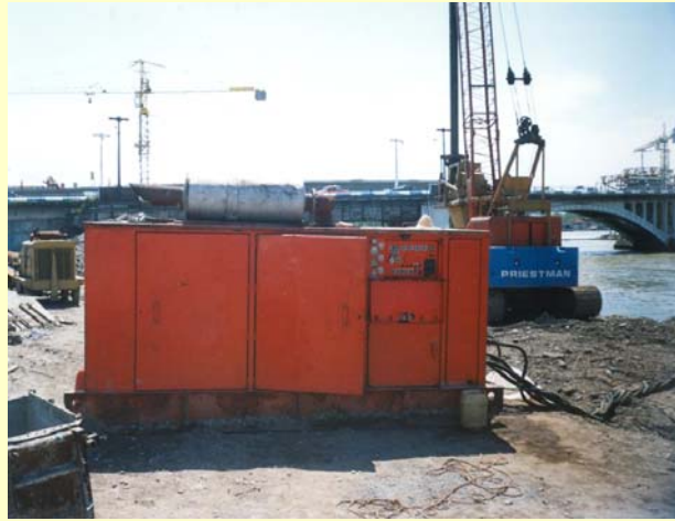
جهت تأمین هوای لازم جهت نیروی محرکه شمع کوب ارتعاشی یا چکش بادی ۶۳
