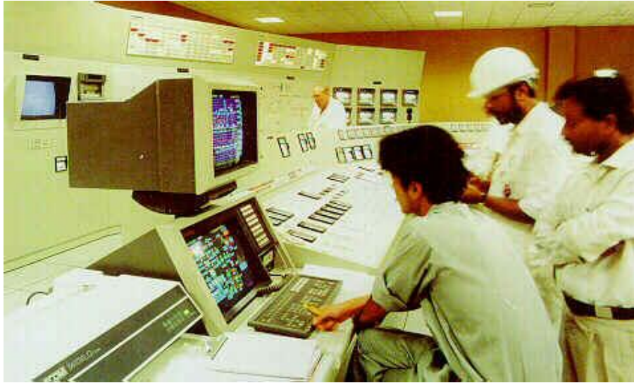
شکل 17-3- اتاق کنترل یک سیستم DCS
