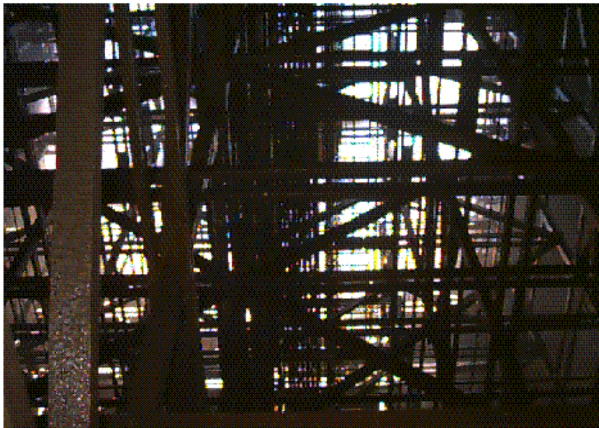
شکل 11-3- تصویر بالا داخل یک Cooling tower طبیعی را نشان می‌دهد.
