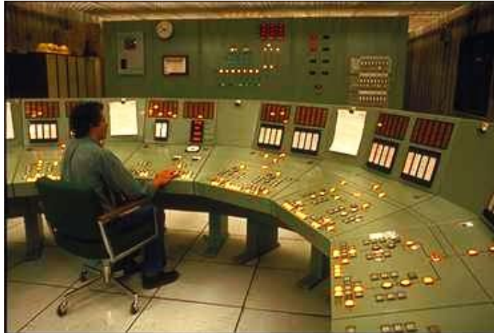
شکل 17-1- اتاق کنترل یک سیستم کنترلی دیجیتال
